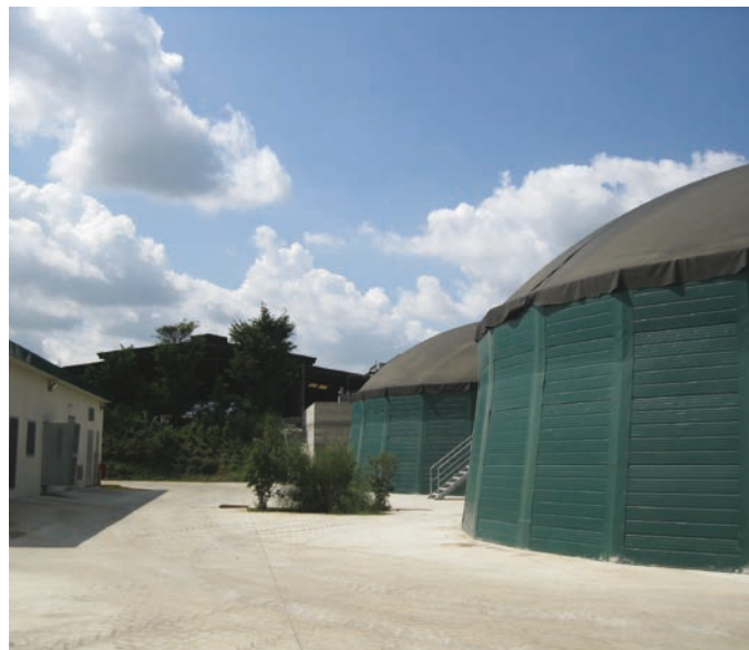
Alle Maserie Saraceno i reflui zootecnici vengono convogliati in due digestori e destinati alla produzione di biogas.
